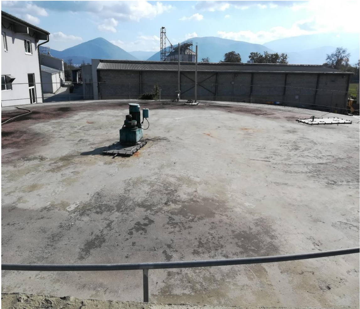
Слика бр.12 Мешалка интегрирана во феремнтаотрот број 1 – Електро Шари с. Требош – Тетово
