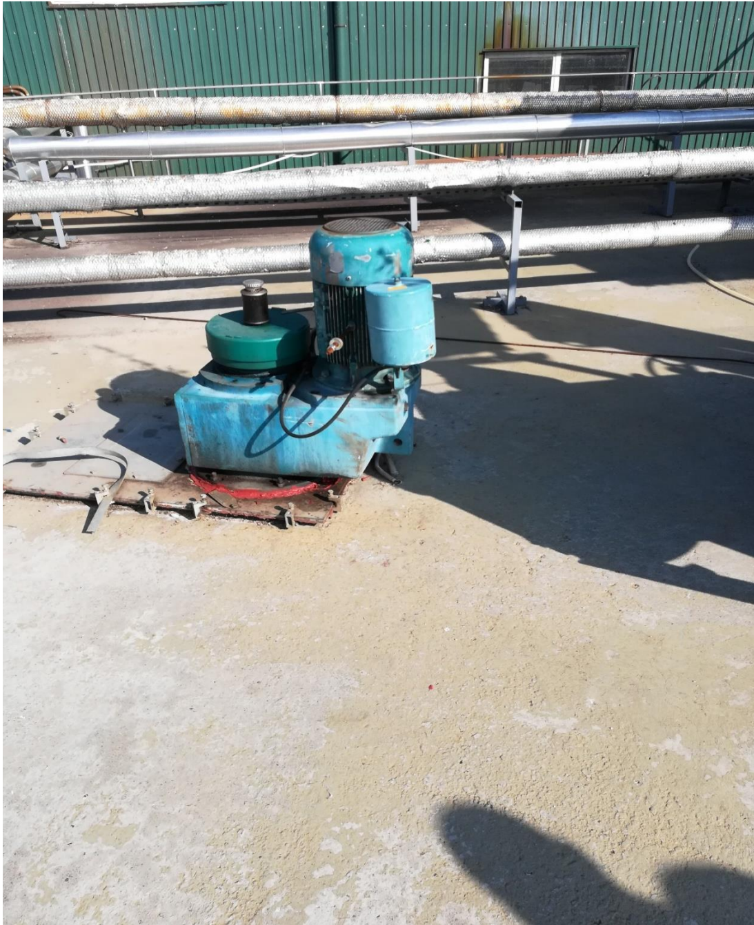
Слика бр.13 Мешалка интегрирана во ферментатор број 1 Електро Шари – с. Требош –Тетово
