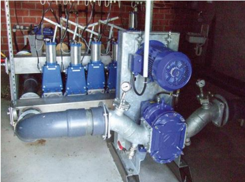
Слика бр.8 Пумпна станица (пример 2) опремена со цевководи, пумпи и стопирачки вентили
