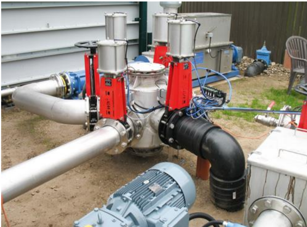
Слика бр.7 Пумпна станица (пример 1) опремена со цевководи, пумпи и стопирачки вентили
